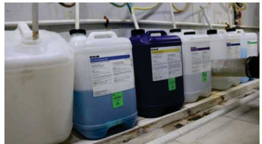
Gambar 6.2. Drum laundry chemical pada washer machine Sumber : Hotel Eastparc, Yogyakarta, 2018
